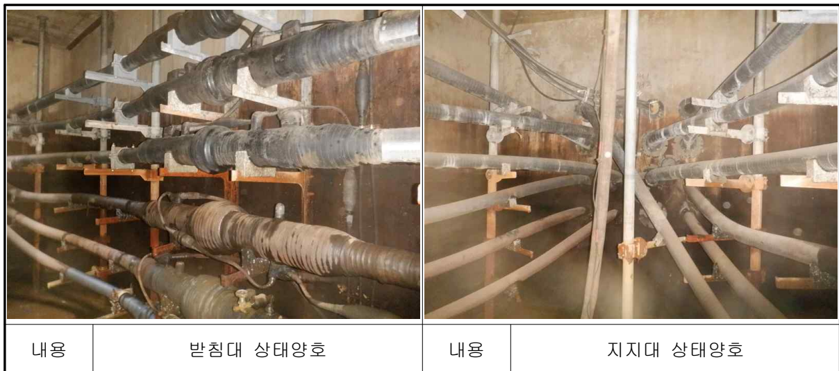
【사진 10.4】 부속 및 부대설비 현황
