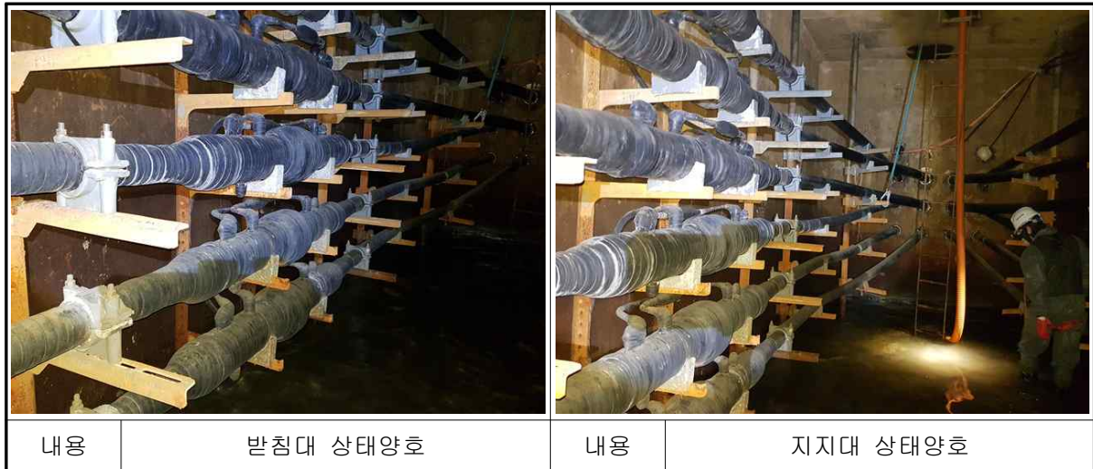
【사진 10.12】 부속 및 부대설비 현황
